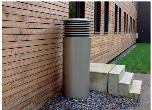
Ansaugöffnung für mechanische Zuluftanlage.
