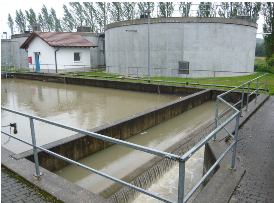
Abb. 8: Regenüberlaufbecken in der Mischwasser- kanalisation
