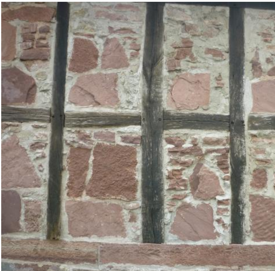
Abb. 6: Fachwerk an einem ehemaligen Gaden der aufgelassenen Kirchenburg in Fuchstadt. Der früher verwendete Lehm wurde im Rahmen musealer Restauration durch Bruchsteine aus Buntsandstein, im wesentlichen Plattensandstein (so2PS), ersetzt, die den Geologen wegen ihres Gefüge-Reichtums anziehen.
