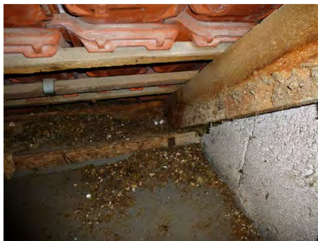
Abb. 4: Mauersegler-Nest ( Apus apus ) mit Eiern im Dachstuhl eines Wohnhauses, der über schadhafte Ziegel für die Art zugänglich war (Foto: Johannes Mayer).
