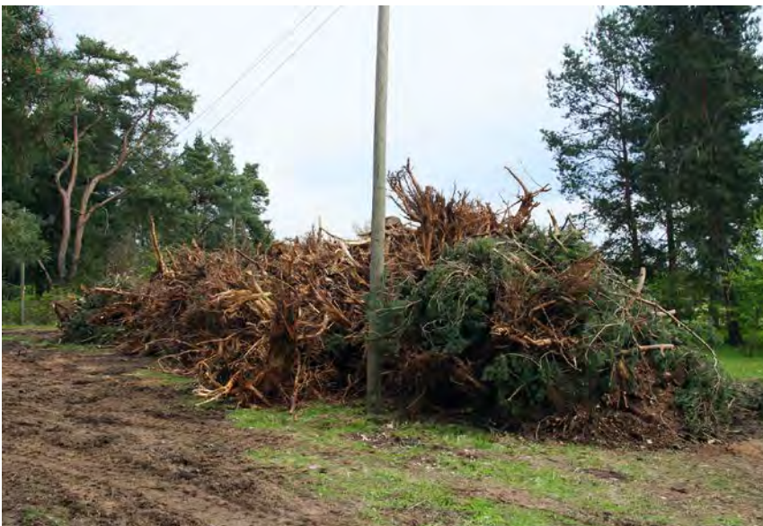
Abb. 4: Ein Großteil der Wurzelstöcke wurde gerodet, gehäckselt und abgefahren, um Initialen für Ruderalvegetation zu vermeiden.
