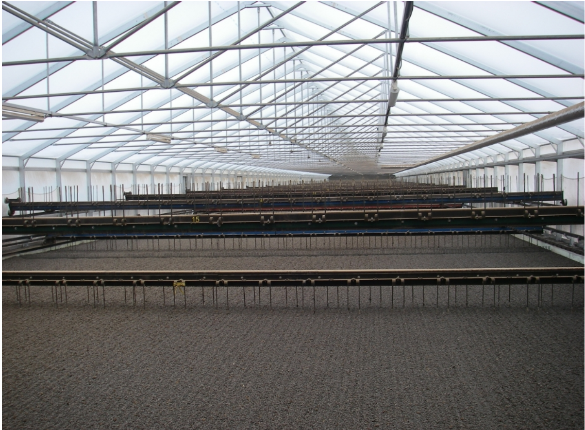
Abb. 9: Solarunterstützte Klärschlamm-trocknung mit Rechen zur Schlammumwälzung
