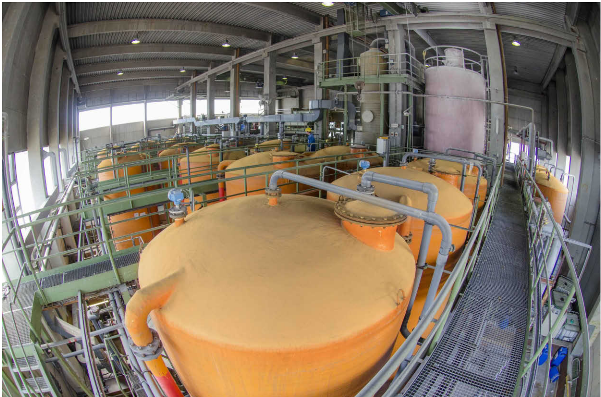
Abb. 9: Chemisch-physikalisch-biologische Reinigungsanlage der GSB in Baar-Ebenhausen
