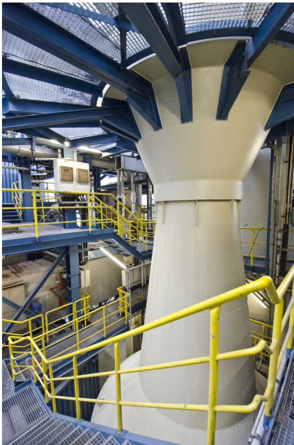
Abb. 5: Abluftreinigung bei der GSB in Baar-Ebenhausen
