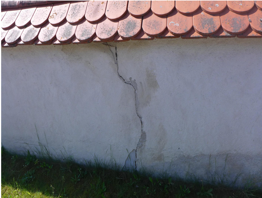
Abb. 12: Rutschung Altisheim. Einer von mehreren Rissen entlang der Kir- chenmauer.
