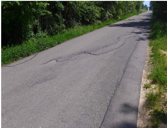
Abb. 4: Rutschung südlich Riedelbergerhof. Der durch die Rutschmassen verlaufende Verkehrsweg zeigt deutliche Aufwölbungen mit Schäden.
