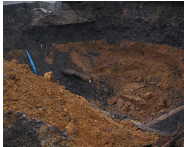
Abb. 18: Bei dem Erdfall wurden unter anderem Versorgungsleitungen zerstört.
