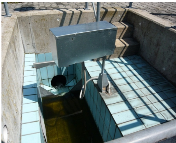
Abb. 3: Dreieckmesswehr in Betrieb
