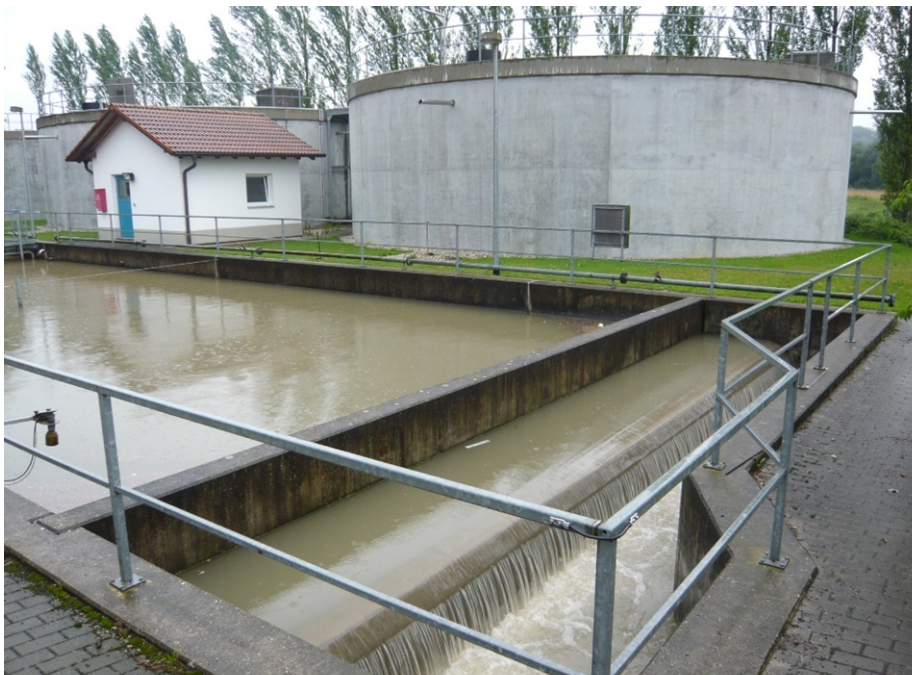
Abb. 8: Regenüberlaufbecken in der Mischwasserkana- lisation
